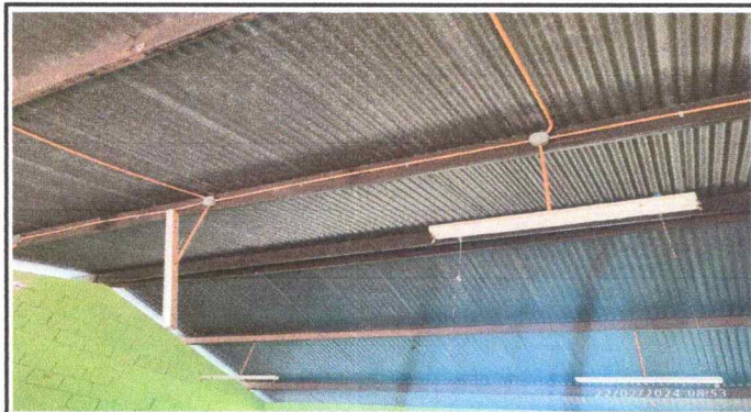
Foto 2: Se observa el deterioro de la estructura portante en el modulo 1
